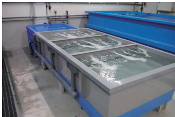
海水冷却設備
